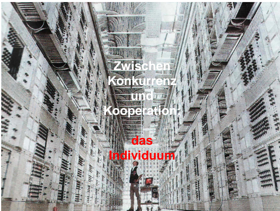
Abb. 9: Verteileranlage eines Telekommunikationsunternehmens
